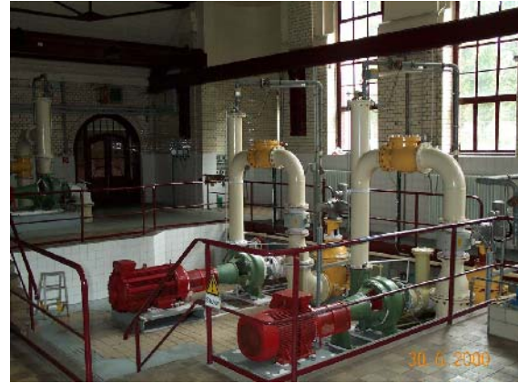
Bild 1.4 Sollte sich in der Pumpstation ein Störfall ereignen, so wird sofort der zuständige Techniker per SMS alarmiert.
